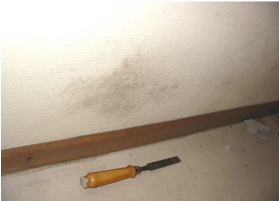
Abb. 9: Schimmelpilzbefallene Aussenwand mit < 0,5 \text{ m}^2 Fläche
